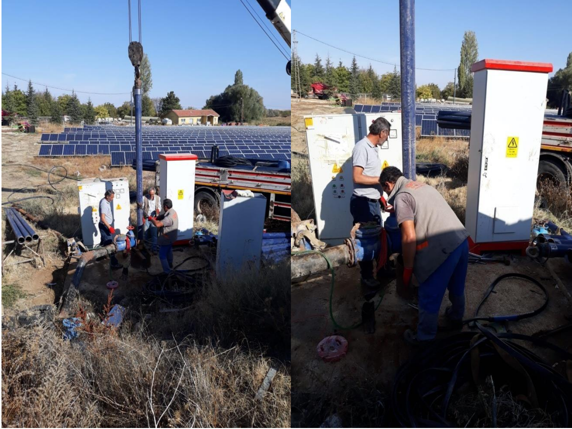
Derin Kuyuların Bakım ve Onarımları Peryodik şekilde yapılarak su kayıpları önlenmektedir.
